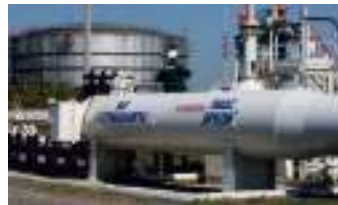
Іл. 45.11. Нафтоперекачувальна станція (Одеса – Броди)
